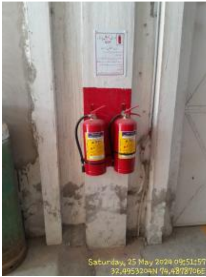
Fire Extinguishers - 2.jpg
