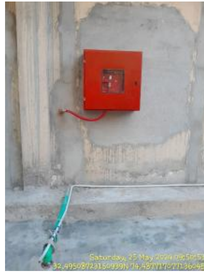
Fire Hose Reel.jpg
