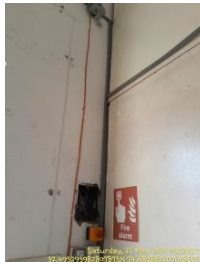
Fire Alarm Call Point.jpg
