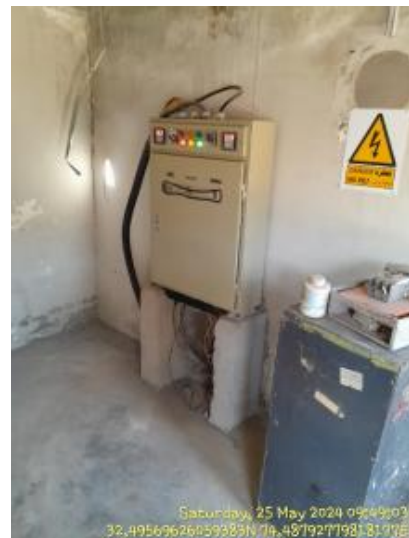
Missing Rubber Mat.jpg
